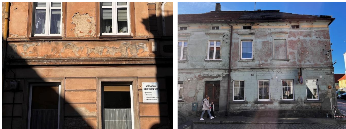
Fotografia 16. Zniszczone elewacje kamienic w Ryнку
